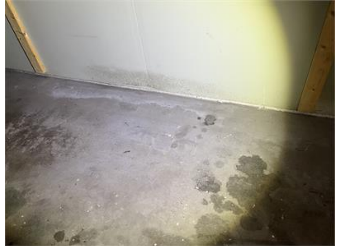
Pos 2. Missfärgningar/mikrobiell påväxt förekommer lokalt på vägg i garage.
