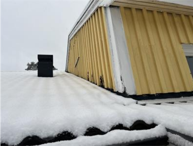
Pos 1. Rötskador förekommer i fasad.
